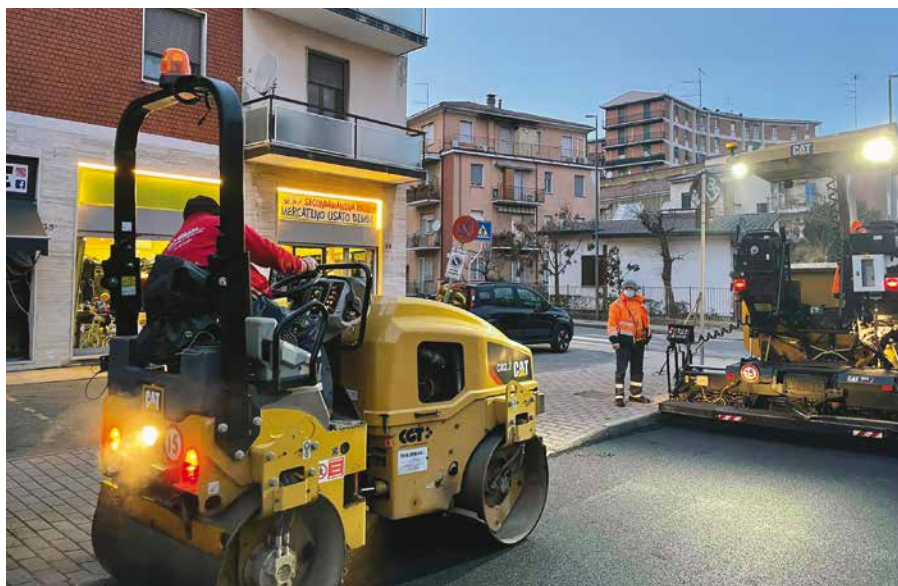
6. La fase di compattazione con il rullo CB2.7: dopo il passaggio della vibrofinitrice, il manto si presenta già precompattato al 90%
